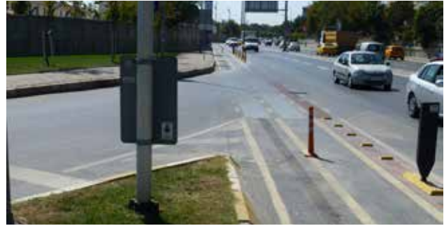
Şekil 103: Devam etmeyen kaldırım (Fikret Yüztalı Caddesi Kavşağı)
