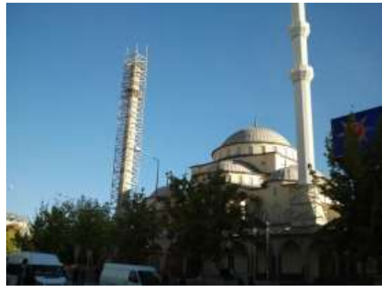
Fotoğraf 31 Tadilatı tamamlanmayan camilerden biri (Hz. Ömer Camii)
